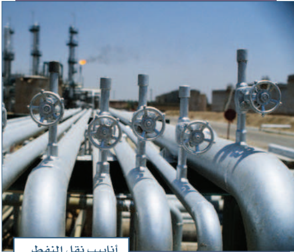
أنابيب نقل النفط
