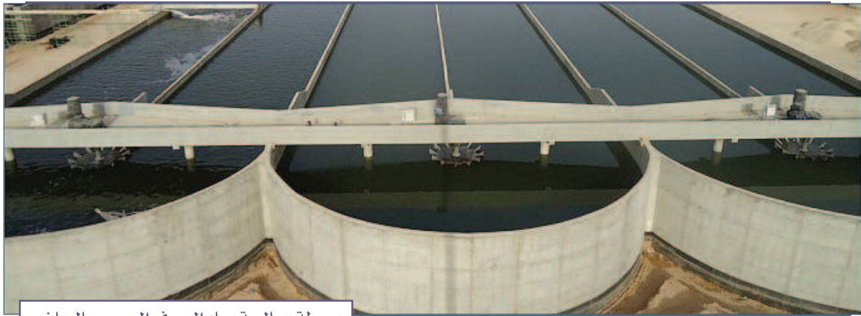
محطة معالجة مياه الصرف الصحي بالرياض
